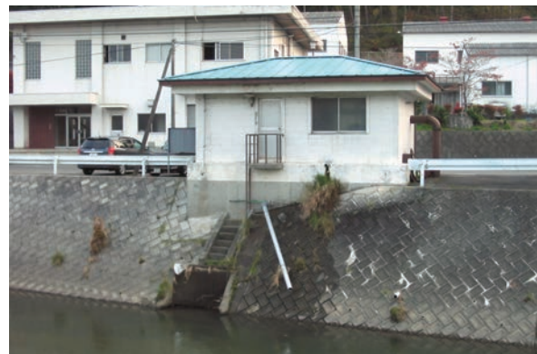
とりいれぐち 〈取入口〉 川の水やわき水をくみ上げます。 (写真は大滝根川の水をくみあげています。)
