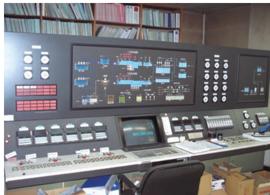
そうさしつ 〈操作室〉 ここで、水の取り入れ、薬の投入、配水などの管理を集中して行います。
