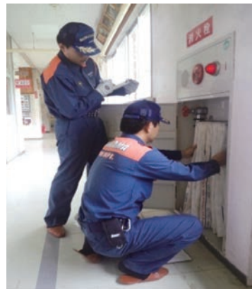
てんけん 消火せつびの点検
